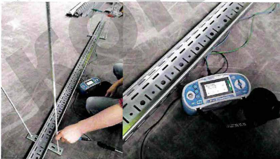
14. Соединение лотка УЛ(П) с профилями монтажными ПП100, в профили установлены шпильки – значение замера 0,02
