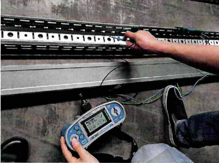
1. Соединение лотков ЛПМЗТ(М) между собой – значение замера 0,01
