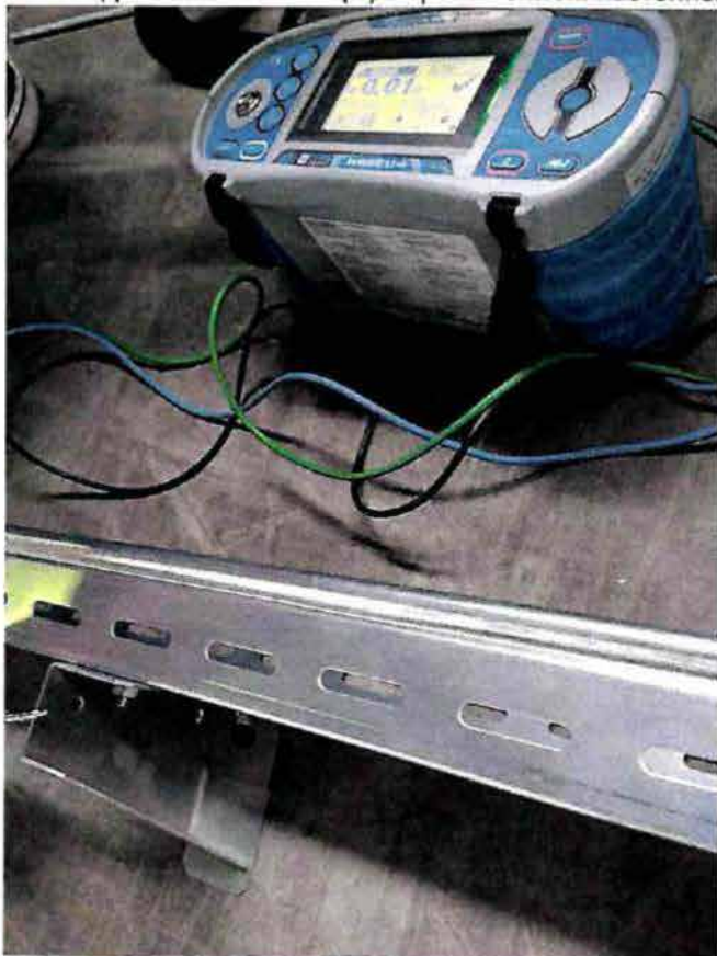
13. Соединение лотка УЛ(П) с кронштейном настенным КНПЛ(СН) – значение замера 0,01
